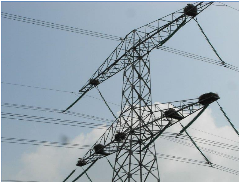
hoogspanningsmast bij Lelystadfoto Arda van der Lee
