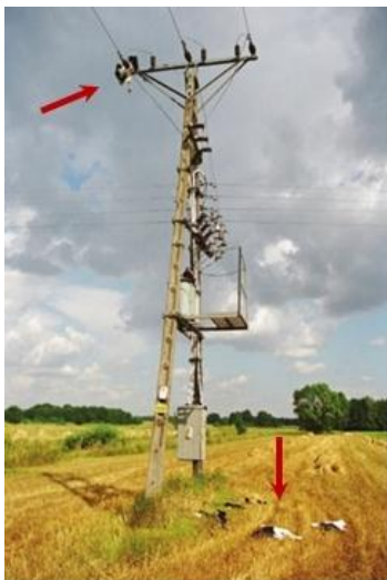
STROOMVERDELER OP DE PAAL= ELEKTROCUTIE
