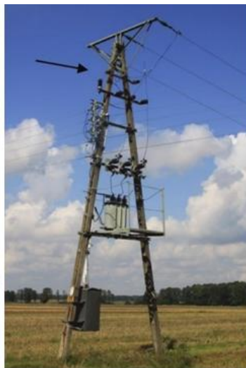
STROOMVERDELER ONDER DE PAAL= VEILIG
